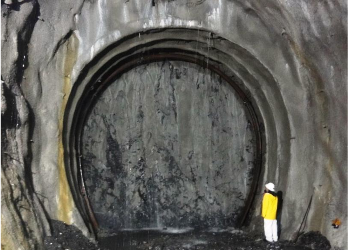
FIGURA 5 – ASPECTO TÍPICO DE FRENTE DE ESCAVAÇÃO DO TÚNEL DE ADUÇÃO FONTE: ODEBRECHT S. A. (2013)
