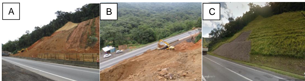
Figura 31: A e B) Fotografias do escorregamento ocorrido em 2014 no km 667 da BR-376, evidenciando a recorrência de escorregamentos neste ponto e as obras de estabilização realizadas. Fonte: (LAGEO, 2014). C) Imagem de maio de 2015, a encosta no km 667 da BR-376 foi novamente retaludada. Fonte: Google Earth, agosto de 2015.
